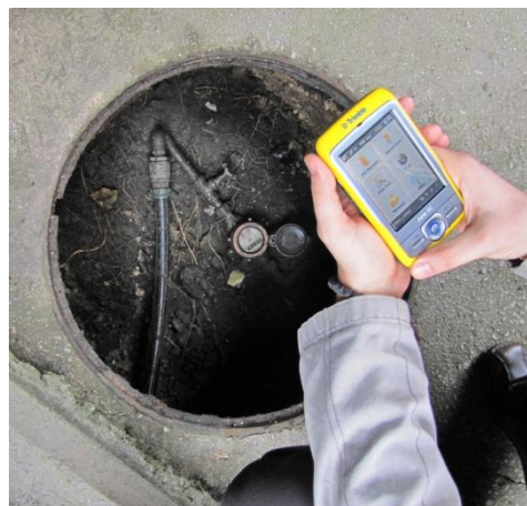
Унос података приликом замене водомера
